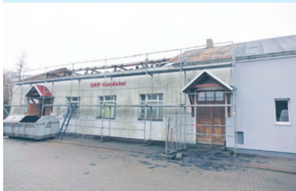
Przebudowa remizy OSP w Grodźcu na potrzeby Biblioteki Publicznej wyniesie ponad 980 tys. zł
