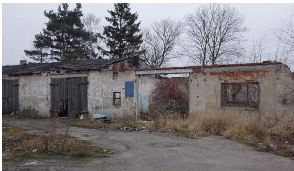
Budynki gospodarcze SKR-u po pożarze
